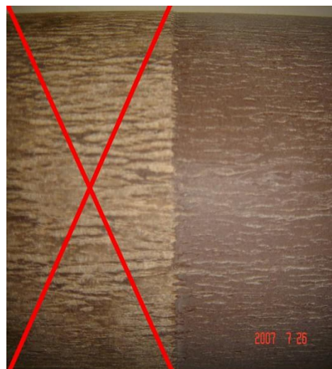
Bild 16 Durch Wasser geschädigte Harzoberfläche
