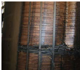
Enroulement principal endommagé
